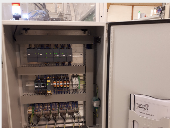
Ny styretavle med PLC og tilhørende dokumentation
